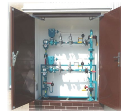
RESO v prefabrikovaném objektu
